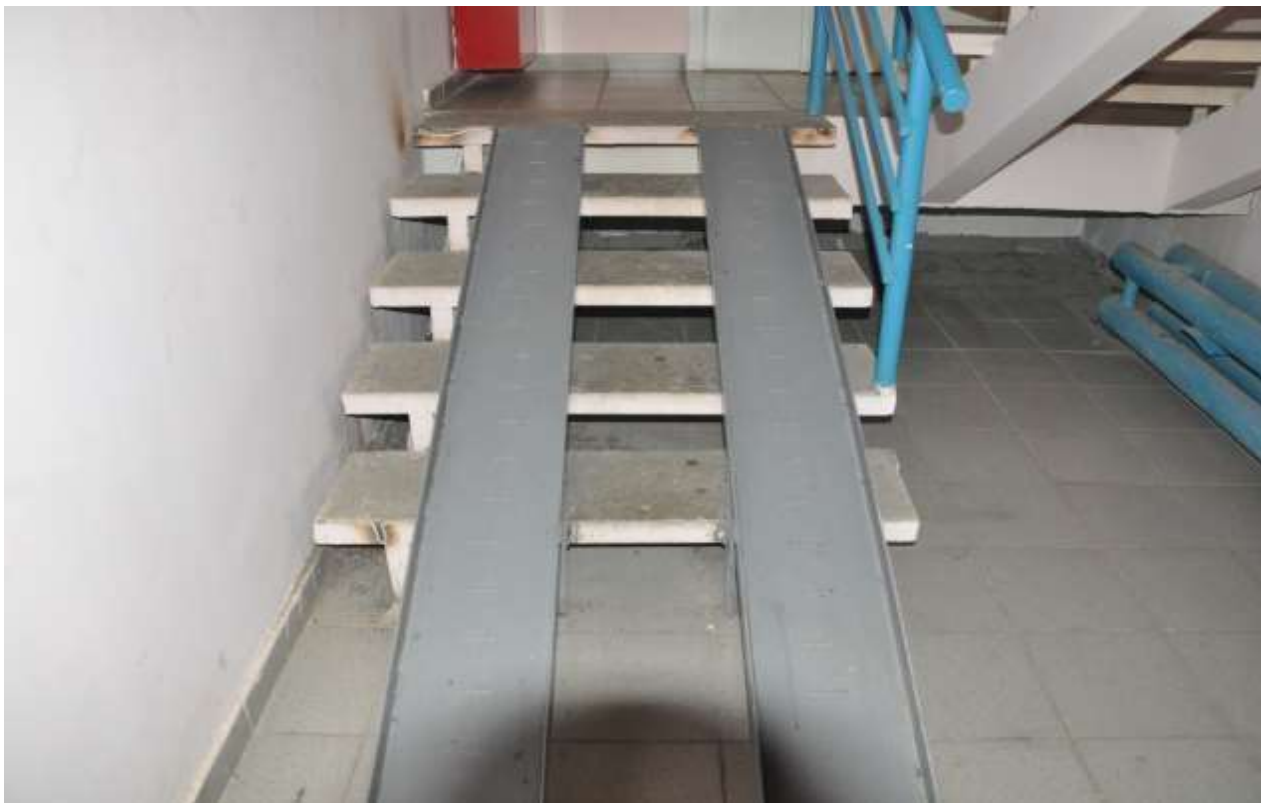
В учебных корпусах установлены направляющие рельсы для колясок, позволяющие маломобильным гражданам преодолевать лестницы (рис.11)
